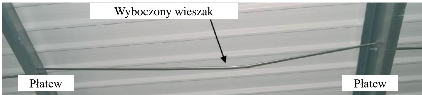
Rys: A. Biegus, Przyczyny przedawaryjnego stanu technicznego płatewi hali stalowej, Budownictwo i Architektura 12 / 2013, 173-180
