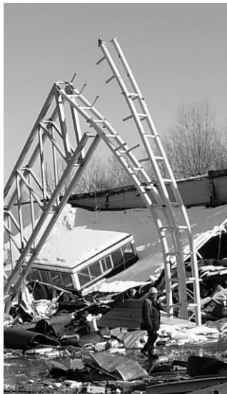
Rys: Z. Mendera, Analiza przyczyn katastrofy hali wystawowej w Katowicach, Awarie Budowlane 2007
