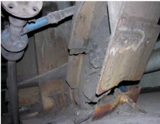
Photo: T. Paczkowska, W. Paczkowski, T. Wróblewski, Wpływ osiadania podłoża na stan stalowej konstrukcji szkieletowej, Awarie Budowlane 2007
